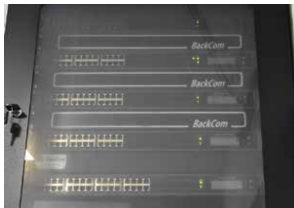
Central telefônica também passou por modernização, troca de cabeamento e novas conexões computadorizadas
